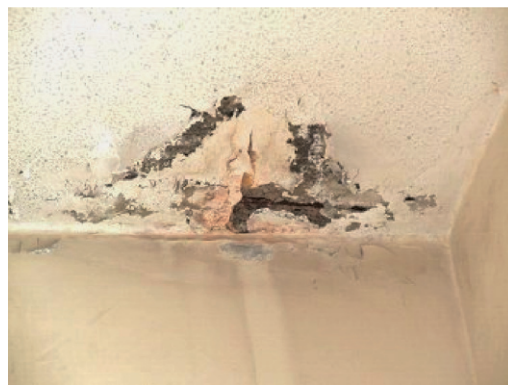
写真-2 鉄筋露出状況（屋内通路天井下面）
